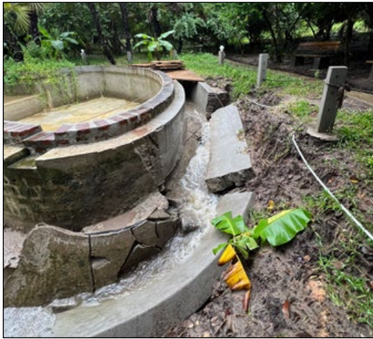
Durch Regen zerstörte Mauer
