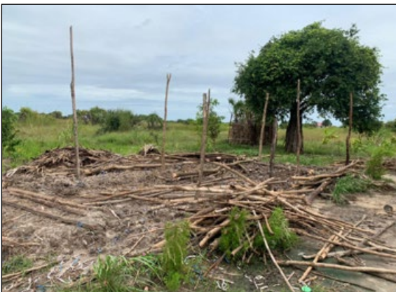
Durch die Regenzeit zerstörtes Wohnhaus der Nachbarschaft
